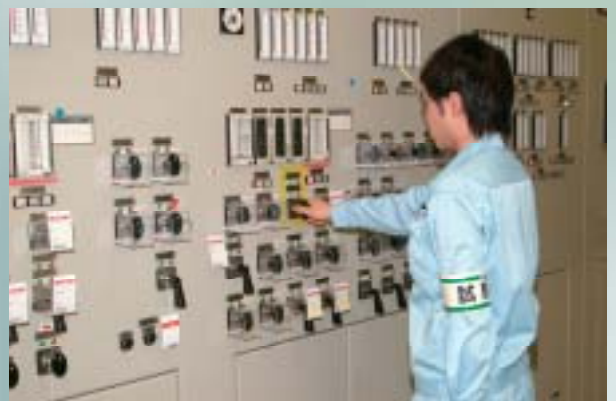
「もんじゅ」工事確認試験 弁開閉試験の様子
